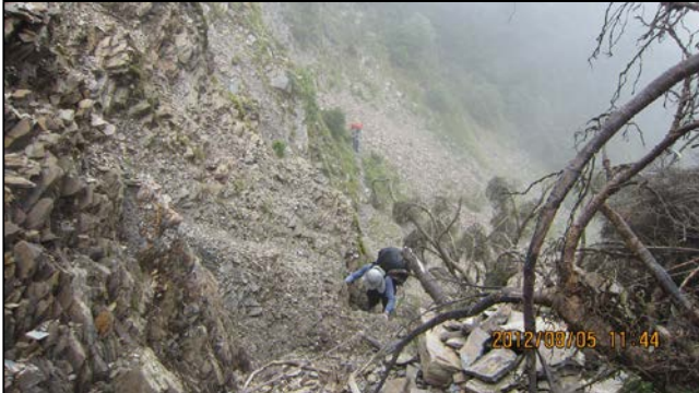
斷崖東段之新增斷崖，原路徑在狹瘦稜脊上已崩落，現須腰繞北側山麓再切回稜脊。
