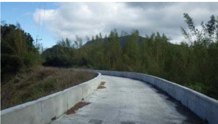
剛修復完的水泥路面，好路到此為止
