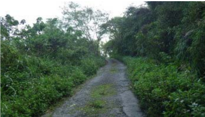
路面已稍有破損
